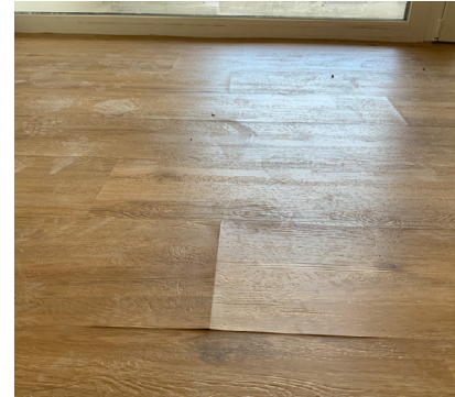
Die Planken wiesen fast auf der gesamten Fußbodenebene Aufkantungen im Stoßfugenbereich auf.
